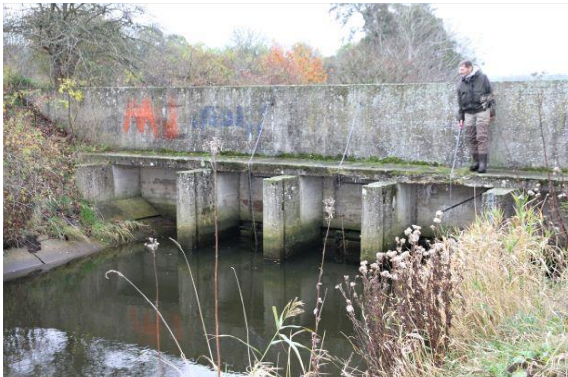
Foto 4. Højvandsslusen i Elverdamsåen kort før udløbet i Tempelkrogen.
